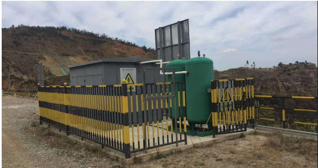
图 2.3-6 气驱式竖向排排渗井的控制机房
