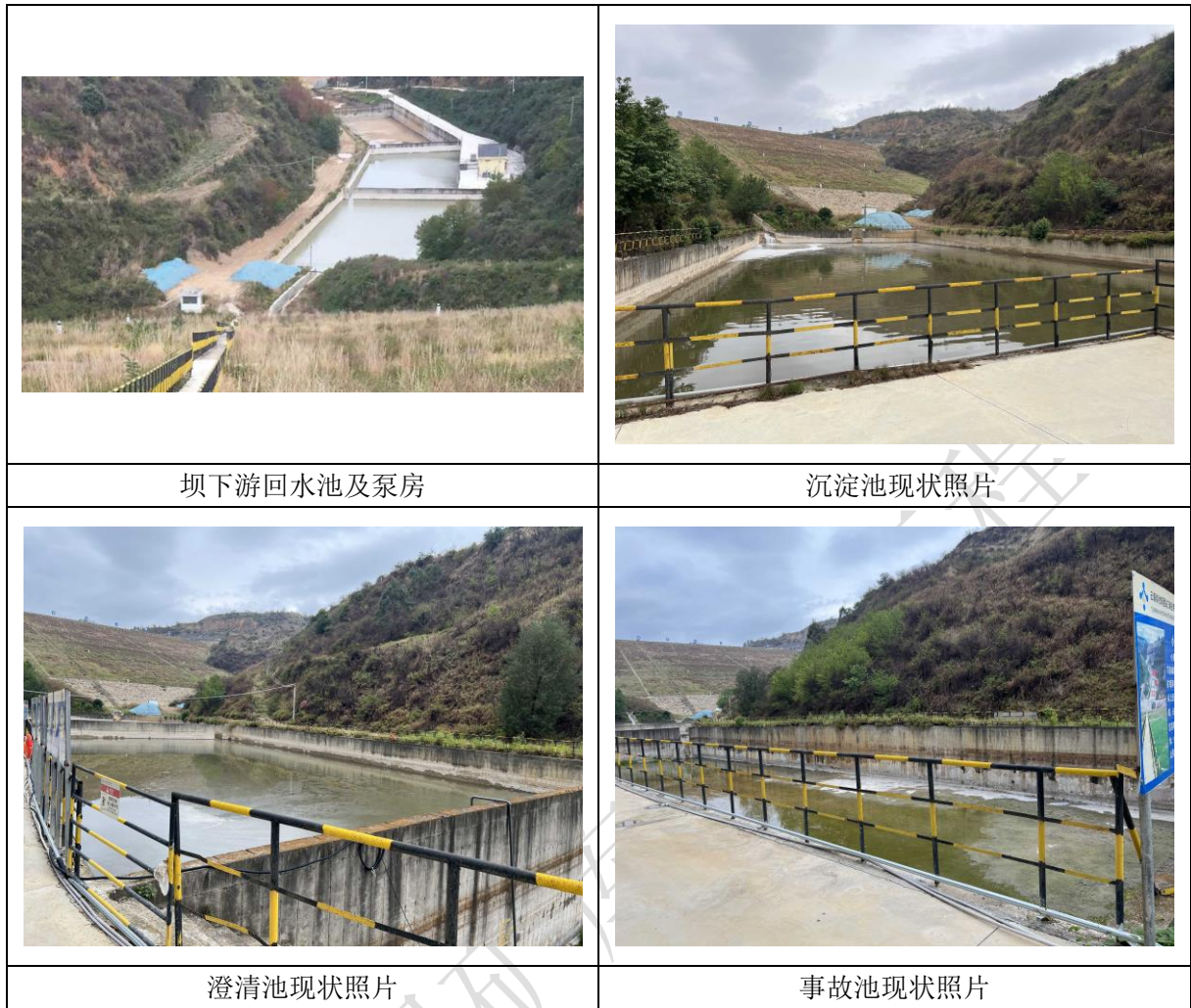
图 2.3-5 回水系统现状照片
